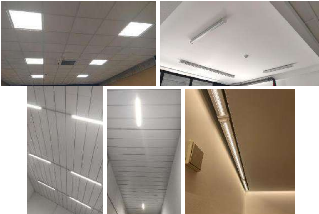
Figura 25. Substituição do equipamento de iluminação por tecnologias LED eficientes para reduzir o consumo de energia
