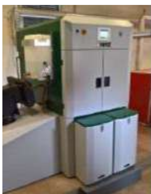
Figura 14. Caldeira de pellets – Campus ESAC/ISCAC
