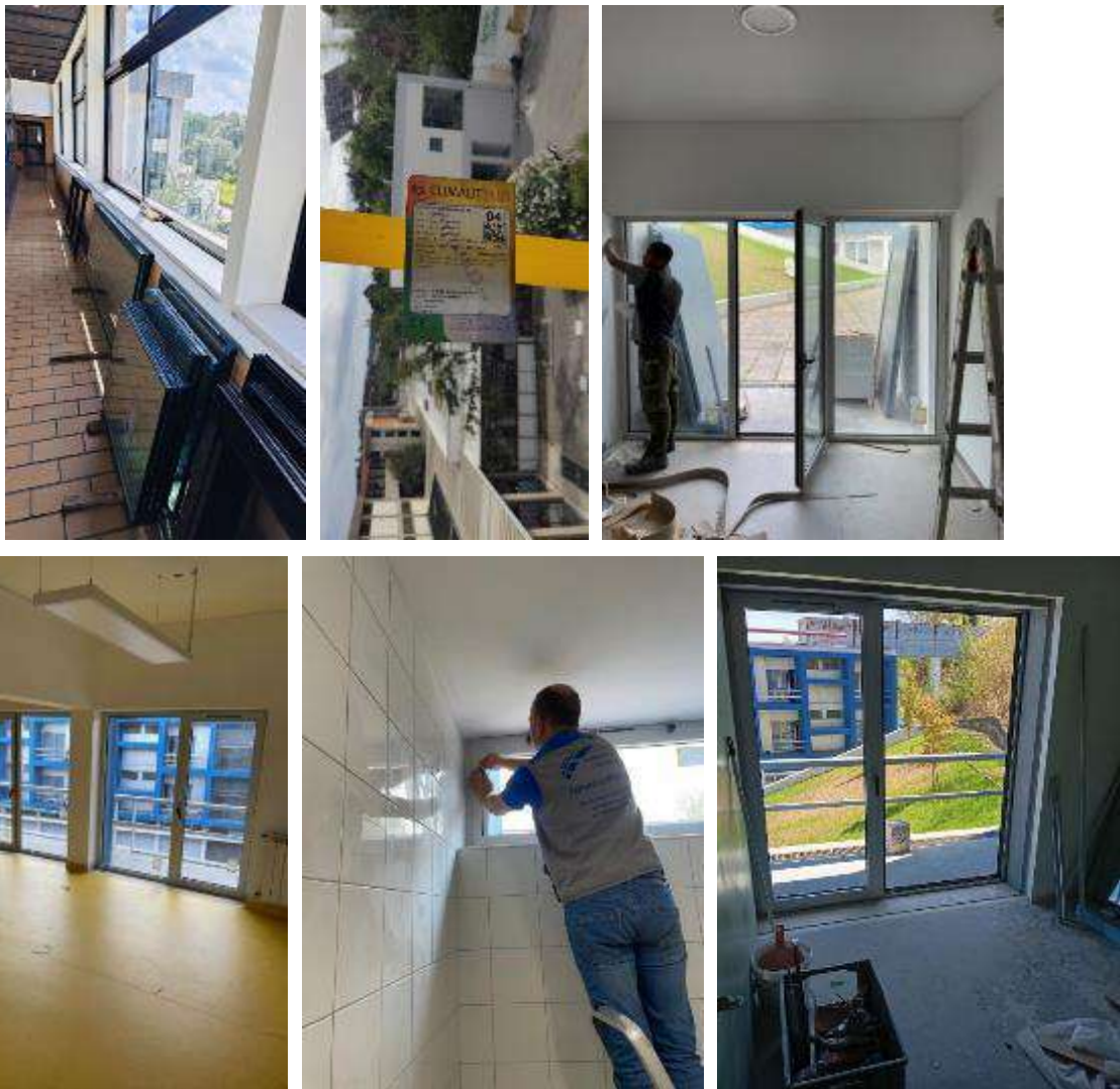
Figura 22. Substituição dos caixilhos das janelas para reduzir o consumo de energia e melhorar o conforto térmico
