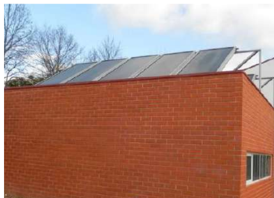
Figura 15. Painéis solares térmicos – Ginásio IPC
