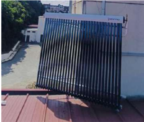
Figura 16. Painéis solares térmicos – Campus ESAC/ISCAC
